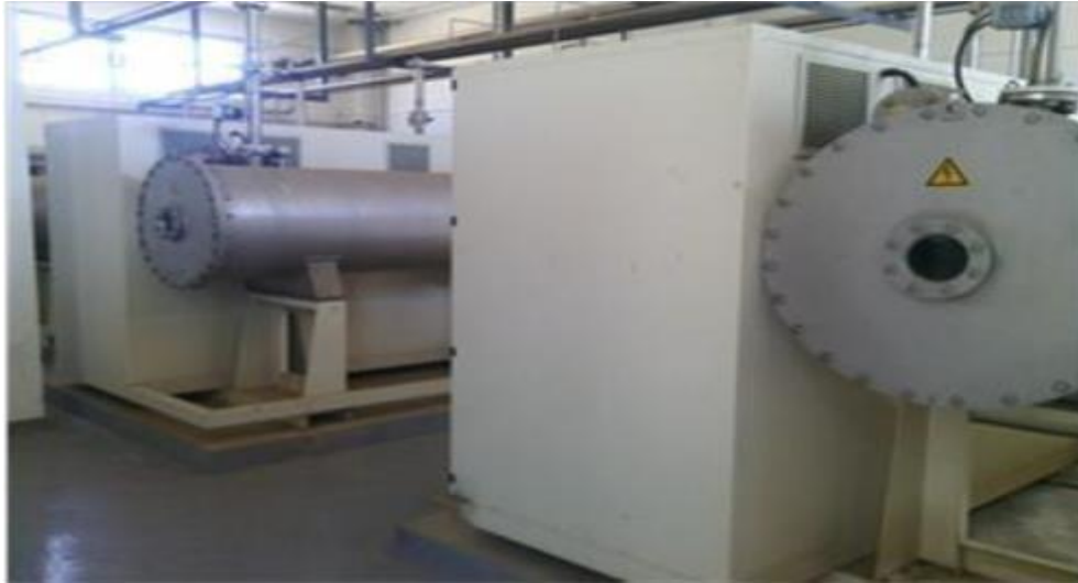
Figure II.9. Générateur d'ozone utilisé dans la station d'Aïn Tinn
