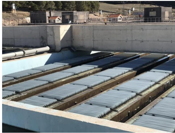
Figure II.14. Décanteur lamellaire de la station de Mahouane.
