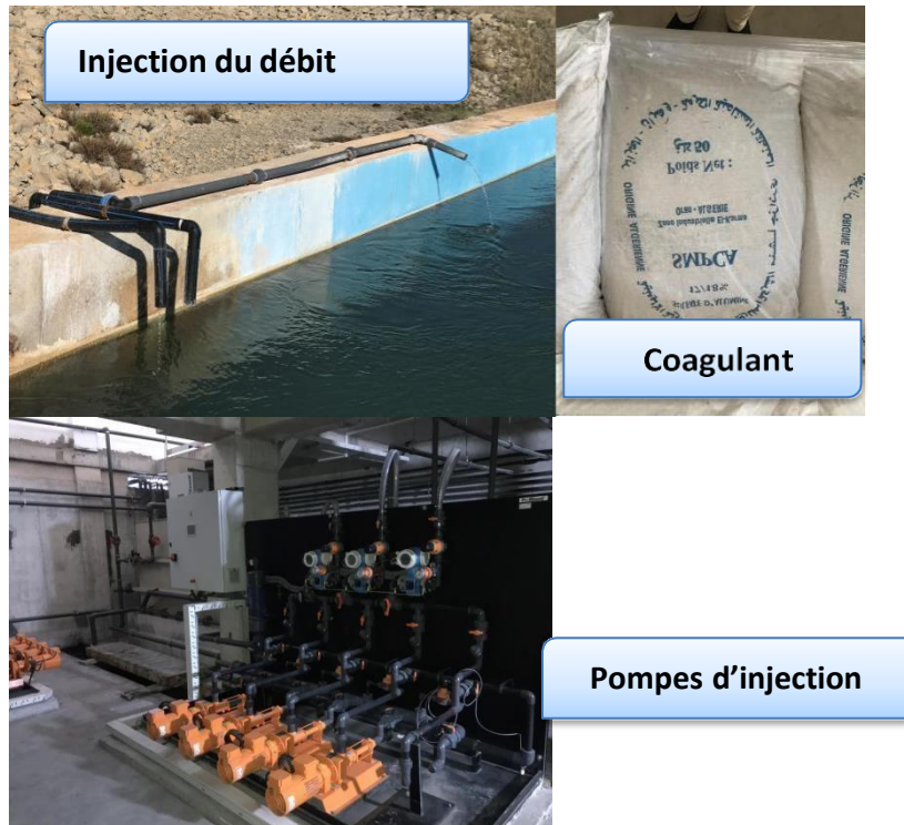
Figure II.10. Coagulant utilisé et procédé d'injection dans les stations
