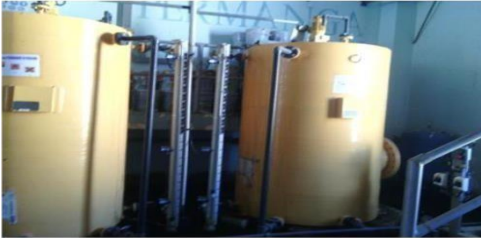
Figure II.8. Système de préparation du permanganate de potassium dans la Station d'Aïn Tinn
