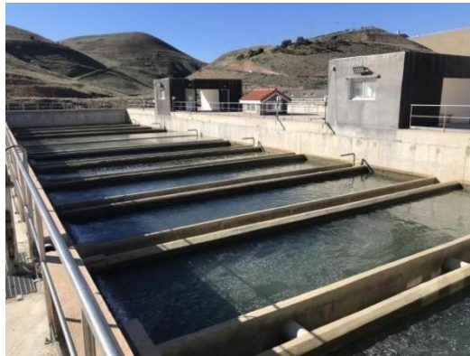
Figure II.15. Bassin de filtration
